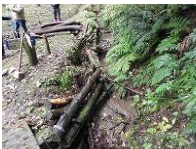
崩れた護岸用の伐採木
